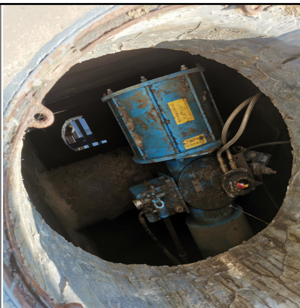
雨污切换阀门（内部）
