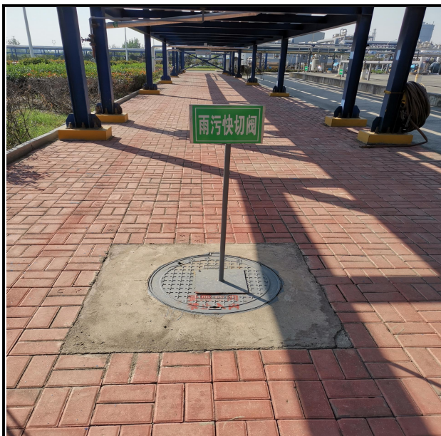
雨污切换阀门（外部）
